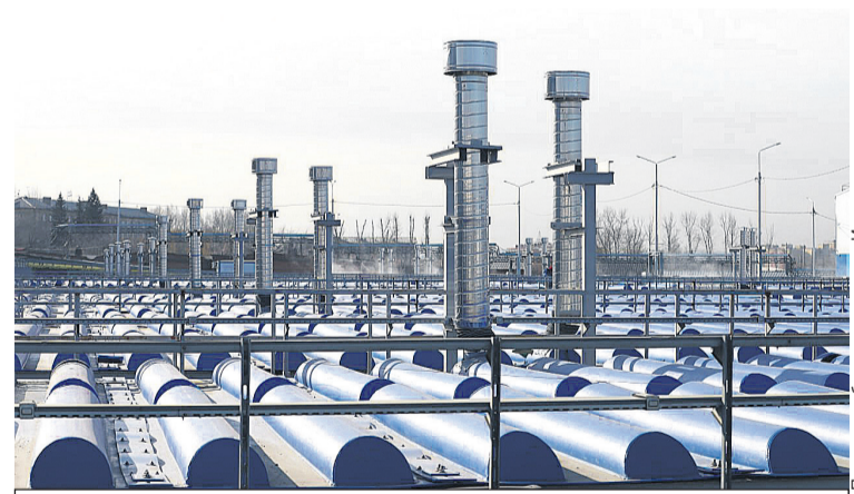
Модернизированные очистные сооружения правого берега.
